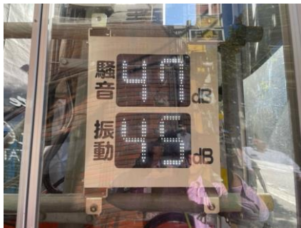
写真-1 振動計測システムの設置例
