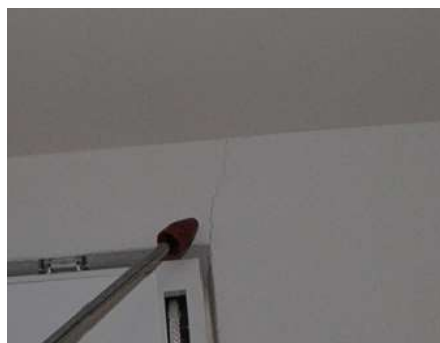
写真-2 珪藻土 (内壁) のひび割れ
