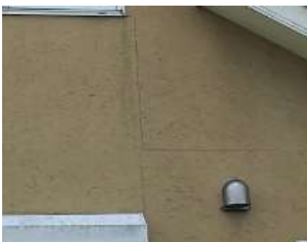
写真-1 ジョリパット (外壁) のひび割れ
